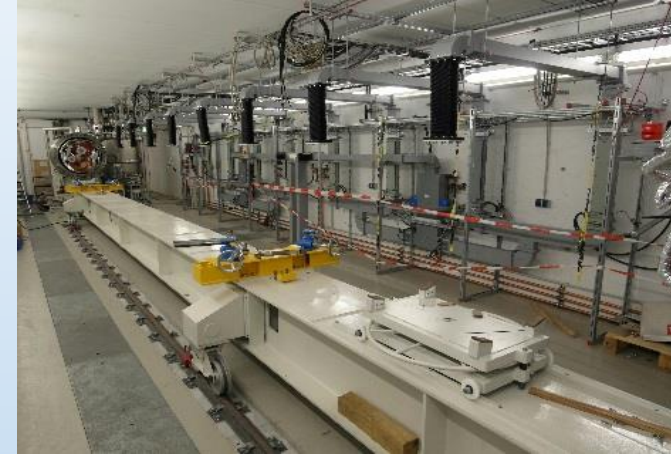
Cryomodule test stand
