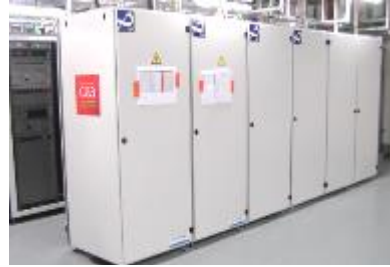
Lignes de transport de faisceaux et armoires d'instrumentation
