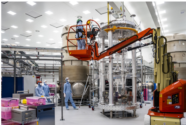
Seismic isolation system, ETpathfinder (Maastricht)
