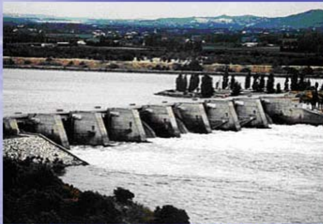
Barrage de Vallabrègues - Usine au fil de l'eau
