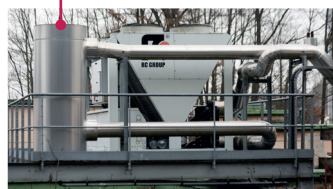
Groupe froid 400KW, dédié au refroidissement des sources de puissance HF et des amplificateurs de puissance RF.
