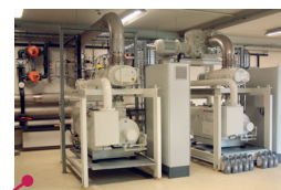
Groupes de pompage hélium qui permettent d'atteindre des températures de l'ordre de 2 °K.
