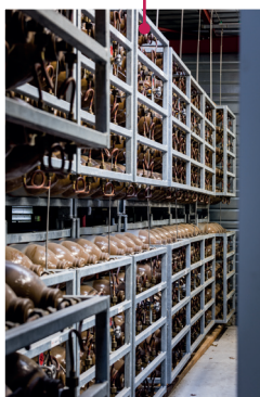
Stockage du gaz à 200 bars équivalent à 3000 L de liquide.
